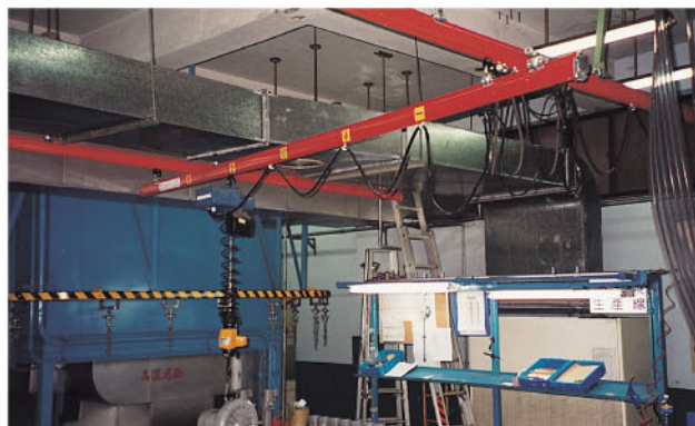
▲ 鼓風機廠生產線吊車設備
